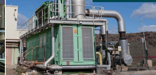
Motor de cogeneración del Ecoparque Gran Canaria Sur.
